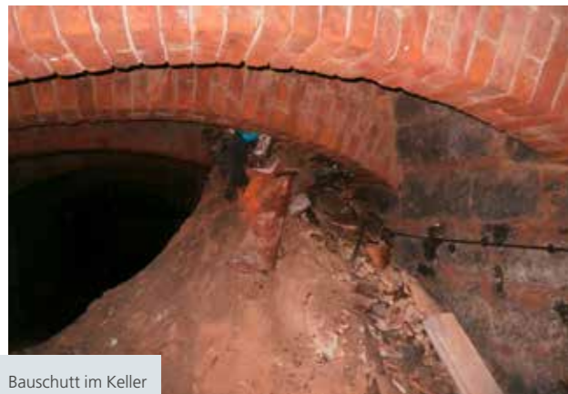
Bauschutt im Keller
